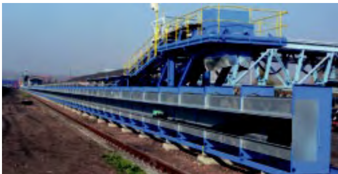
Der weltweit längste igus®-Verfahrsweg von 615 m mit E-Ketten® und Chainflex®-Leitungen
