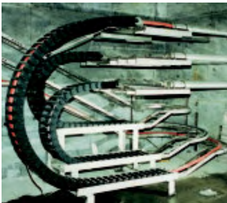
Das igus® Programm bietet pro Kettenserie bis zu 12 verschiedene Biegeradien ab Lager an - Hier das Storebaelt-Brücken-Projekt
