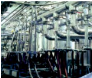
igus® Fabrik: Automatische Compoundier- und Fördereinrichtung für igumid G
