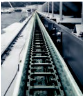
Förderanlage im Steinbruch, Verfahrsweg 179 m, Verfahrgeschwindigkeit 67 m/min, Füllgewicht 8 kg/m
