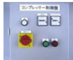
制御盤操作部
