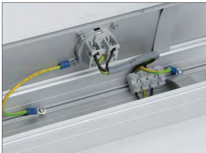
Compensazione di potenziale tramite capocorda
