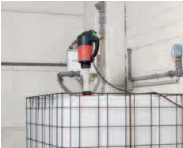
Fördern von galvanischem Abwasser in ein höher gelegenes Entsorgungsnetz.
