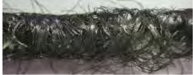
Die Detailbetrachtung des Schirmgeflechts zeigt deutliche Beschädigungen der Schirmdrähte.
