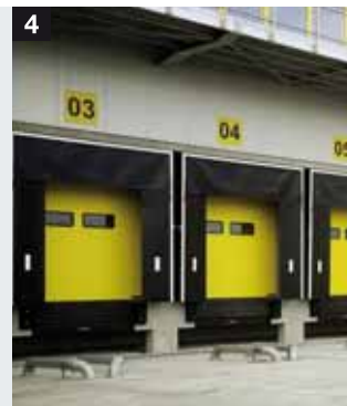
4 Equipements de quai
