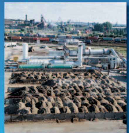
Brennkammer für 50 000 m 3 N /h Abluft für ein neues Bodensanierungskonzept. Die Anlage ist semimobil ausgeführt und kann damit projektbezogen versetzt werden. Mit dieser Gesamtanlage wurden erstmals in Europa kontaminierte Bodenmengen bis zu 100 t/h thermisch gereinigt!
