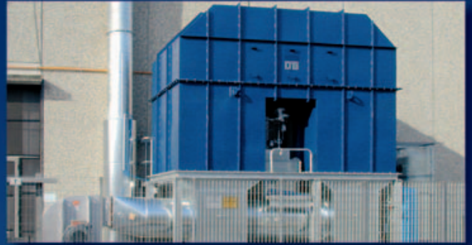
Metallverpackung: TRA 15 000 zur Abluftreinigung von 2 Metalldruck- und Lackierlinien
