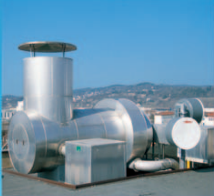
Zur Geruchsbeseitigung im ppm-Bereich in der Abluft dient diese Brennkammer BK 2 000 für eine Gewürzfabrik.
