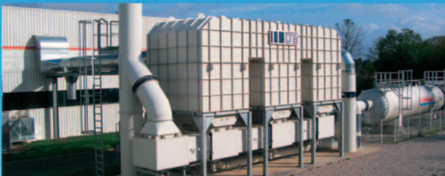
Flexodruck: TRA 2-Turm mit drittem Turm als Puffer für 30\,000 \text{ m}^3_{\text{N}}/\text{h} für Abluft aus einer Flexodruckerei. Die TRA kann im Falle von höheren Lösemittelkonzentrationen zu einer klassischen 3-Turm-TRA umgerüstet werden.
