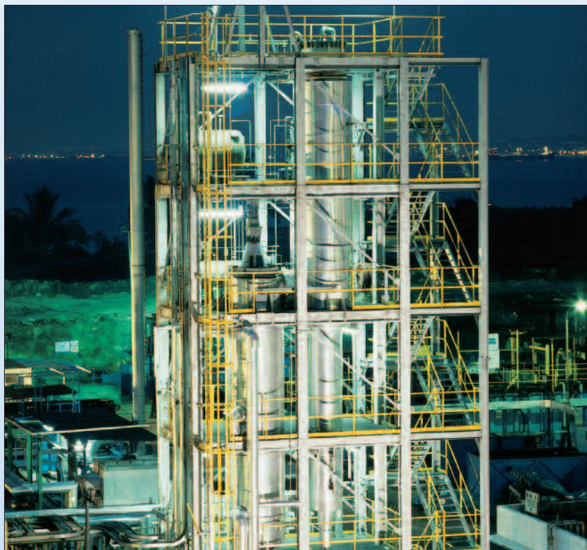
Unité de distillation d'huiles usagées.
