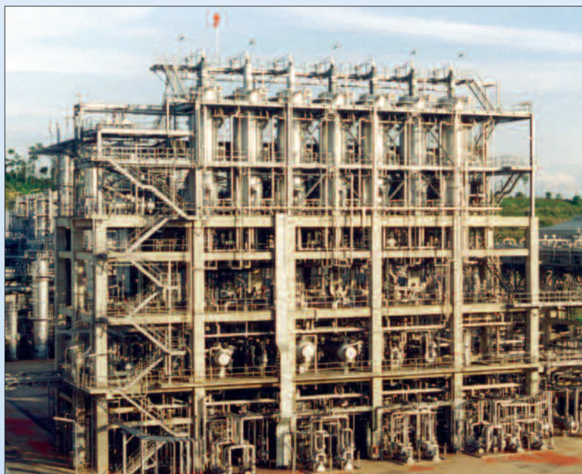
La plus grande ligne d'évaporation à court trajet multi-étagée du monde est sortie des ateliers de production de Buss-SMS-Canzler. Le client est un fabricant de cires molles et dures de renommé en Asie du Sud-est.
