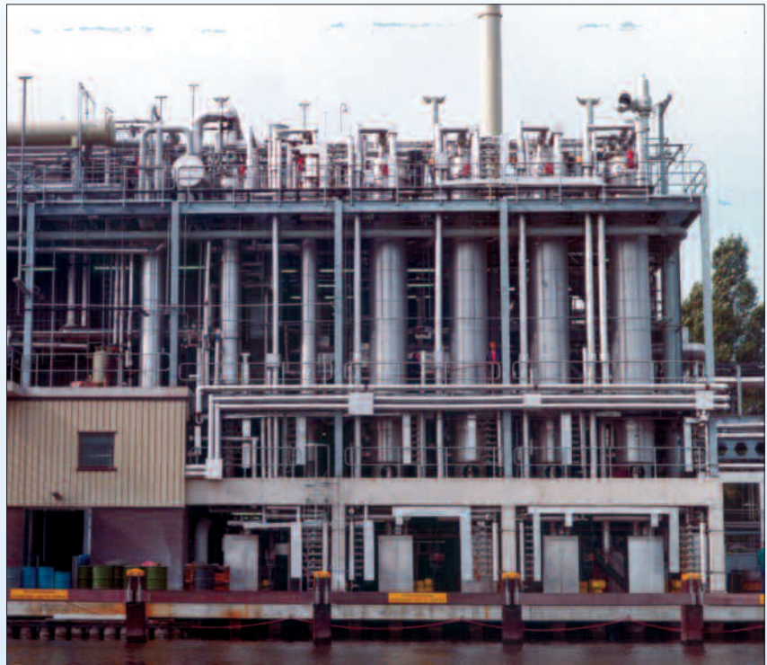
Installation multiple effet d'évaporation à film tombant pour la distillation du miscella.
