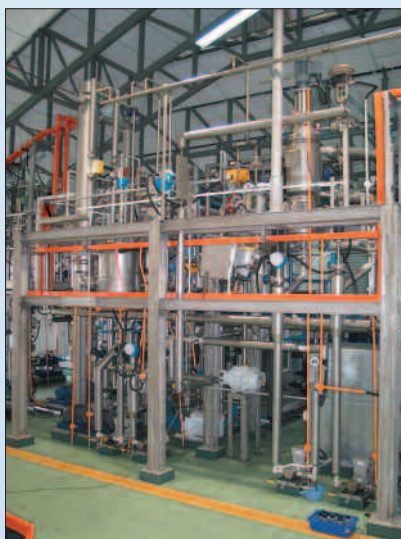
Installation multiple effet d'évaporation à film tombant pour la distillation de micelle.
