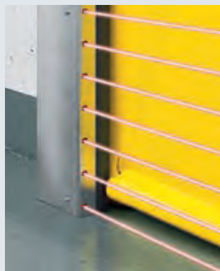
350 mm hohes Lichtgitter verdeckt in der Torführung montiert
