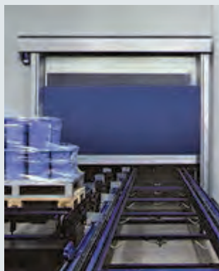
Ein Sichtfeld ermöglicht Einblicke in den Betriebsablauf
