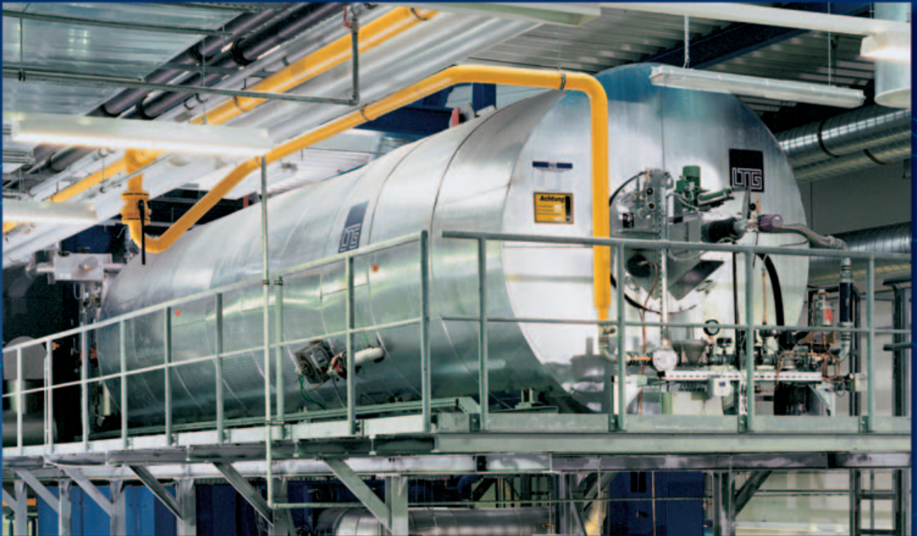
TNV-Anlage für die Reinigung von phenolhaltiger Abluft aus einer Luftfilterproduktion (Plissiermaschinen und Papiertrockenöfen). Die hohe interne Wärmerückgewinnung und ein nachgeschaltetes Warmwasser-Abhitzesystem garantieren eine wirtschaftliche Betriebsweise.
