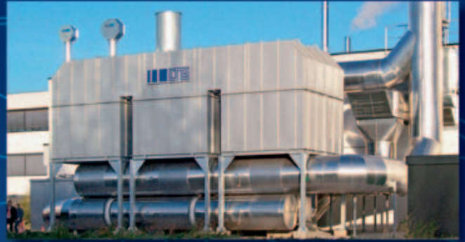
Oberflächenveredelung Consumer-Industrie: TRA 3-Turm 60 000 m 3 N /h in der Rasiererproduktion eines namhaften Herstellers mit niedrigsten Energieverbräuchen durch XtraComb ® und nachgeschaltetem Frischluftvorwärmer zur Trocknerbeheizung.
