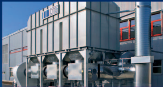
Metallverpackung: Die Abluft aus 2 Bandtrocknern wird mit dieser TRA 20 000 mit speziellem Burn-Out-System gereinigt.
