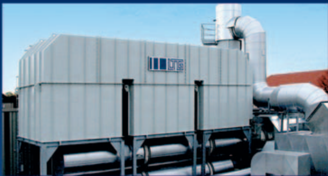
Dekordruck: Abluftreinigungsanlage TRA 60 000 für 2 Dekor-Tiefdruckmaschinen mit Burn-Out, Trocknungsprozess und Reingasrückführung zur Energieoptimierung.
