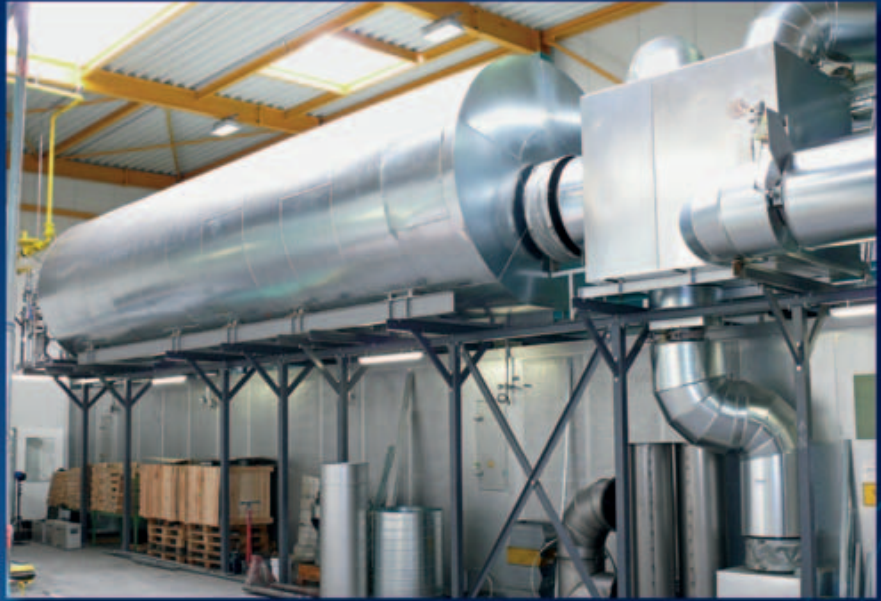
„ECO-TNV“ für 12 000 m 3 N /h Abluft einer Blechlackierlinie mit Lösemittelkonzentrationen bis zu 8 g/m 3 N mit wirtschaftlichem Stand-by-Betrieb.
