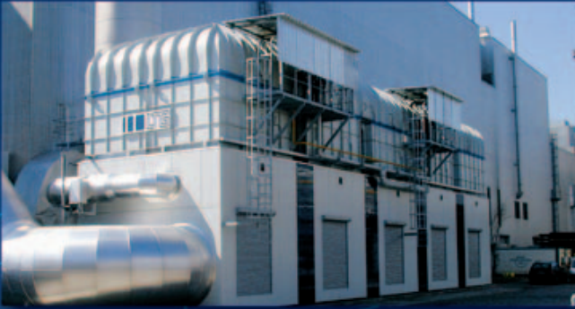
Geruchseliminierung aus Gießerei: TRA in 5-Turm-Bauweise zur Reinigung von 200 000 m 3 N /h Abluft aus der Leichtmetallgießerei eines bayerischen Automobilherstellers.
