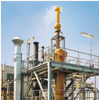
Rauchgaswäsche 1.500 Nm 3 /h
