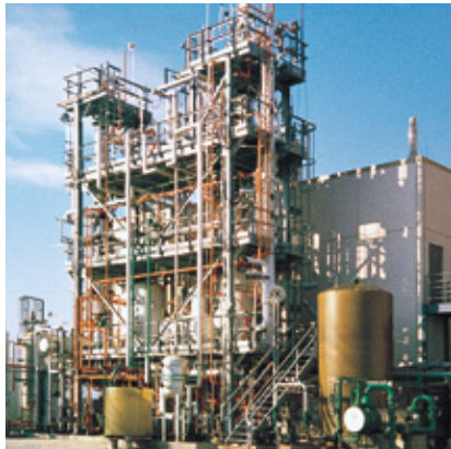
Redundante Rauchgas- reinigung in einer Chemieanlage für 2.000 Nm 3 /h
