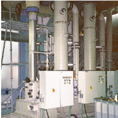
Bypass-Anlage zur Rückgewinnung von Salzsäure aus Rauchgas
