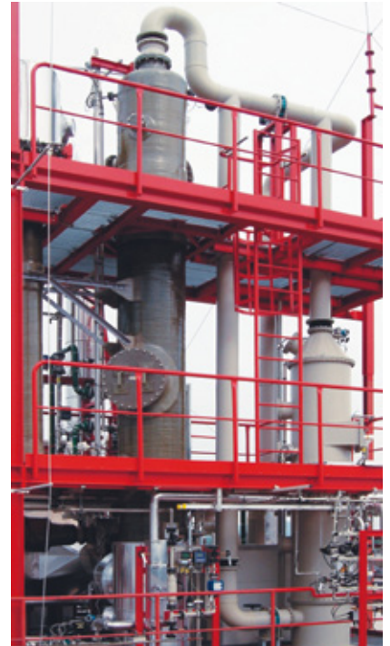
Absorber mit elektrostatischem Aerosolabscheider (Durchsatz 2.500 Nm 3 /h)
