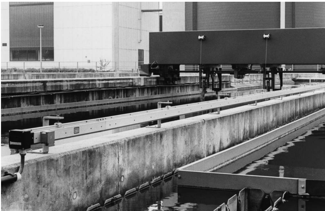
Conducción LSV con calefacción en una planta depuradora de aguas
