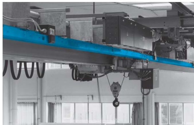
Conducción LSVG en el Carro de un Puente-grúa.
