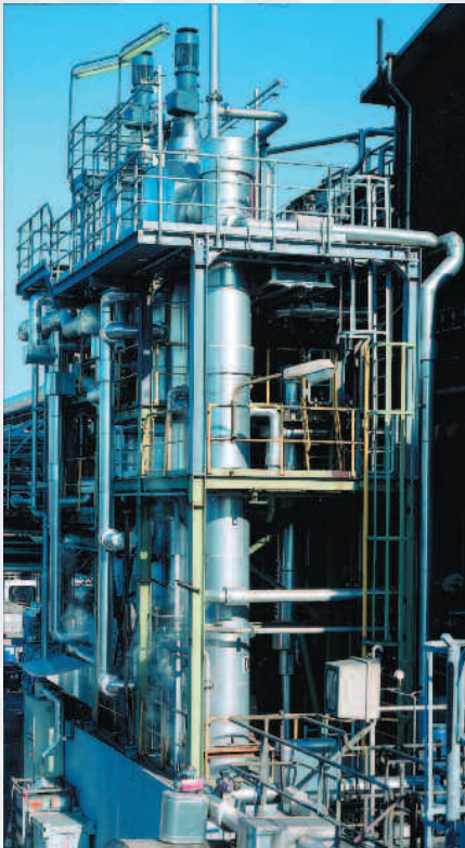
Zweistufige Dünnschichtverdampferanlage zur Harzkonzentrierung
