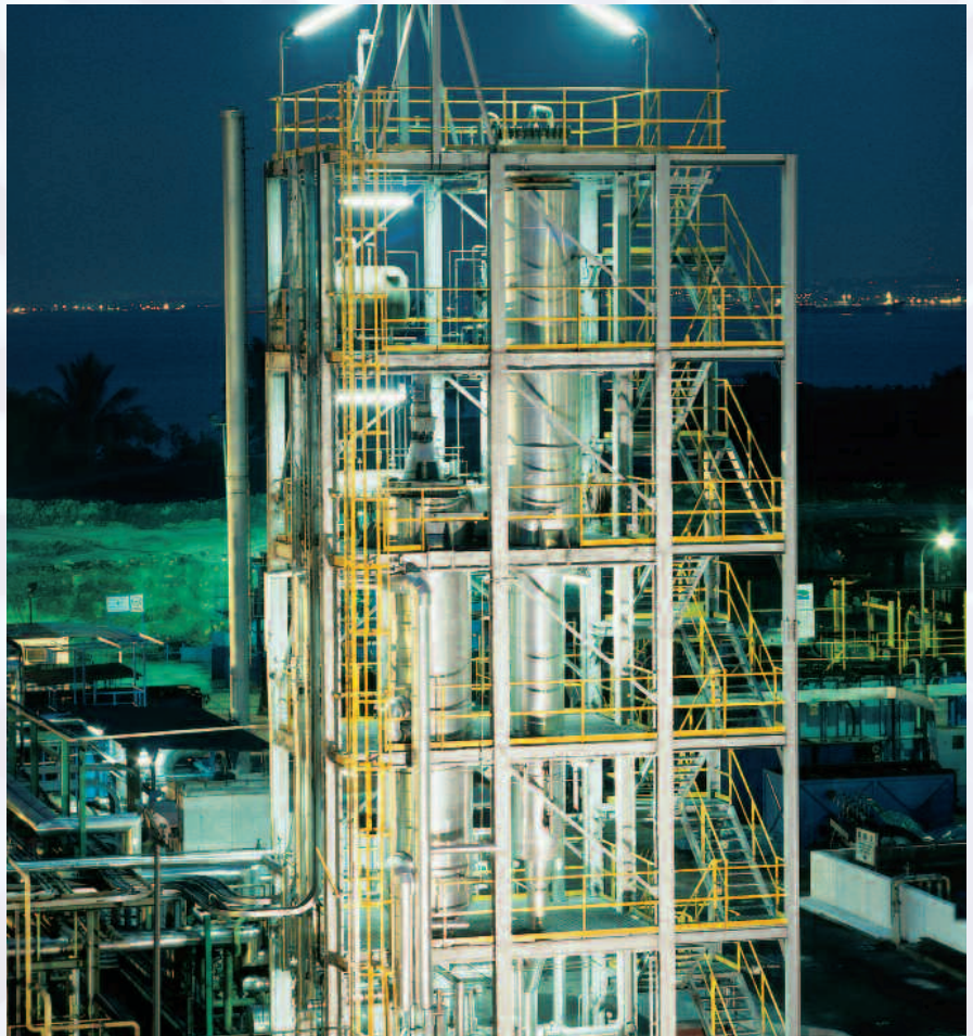
Slop-Oil-Entwässerung und -Destillation (Singapur)
