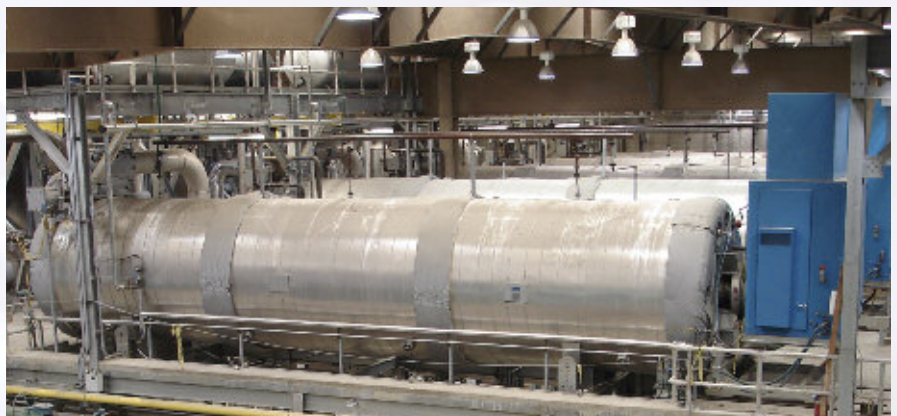
Anlage für die Klärschlammrocknung in den USA
