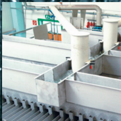
Überprüfung eines Rinnenverteilers
