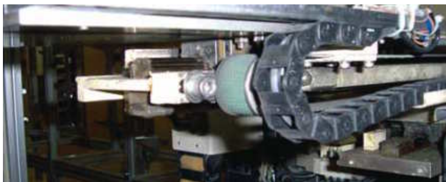
Automatisierte Stapelanlage für Phosphorbildschirme: gerader Installationsraum, kleiner Biegeradius, 300.000 Doppelhübe pro Monat.
