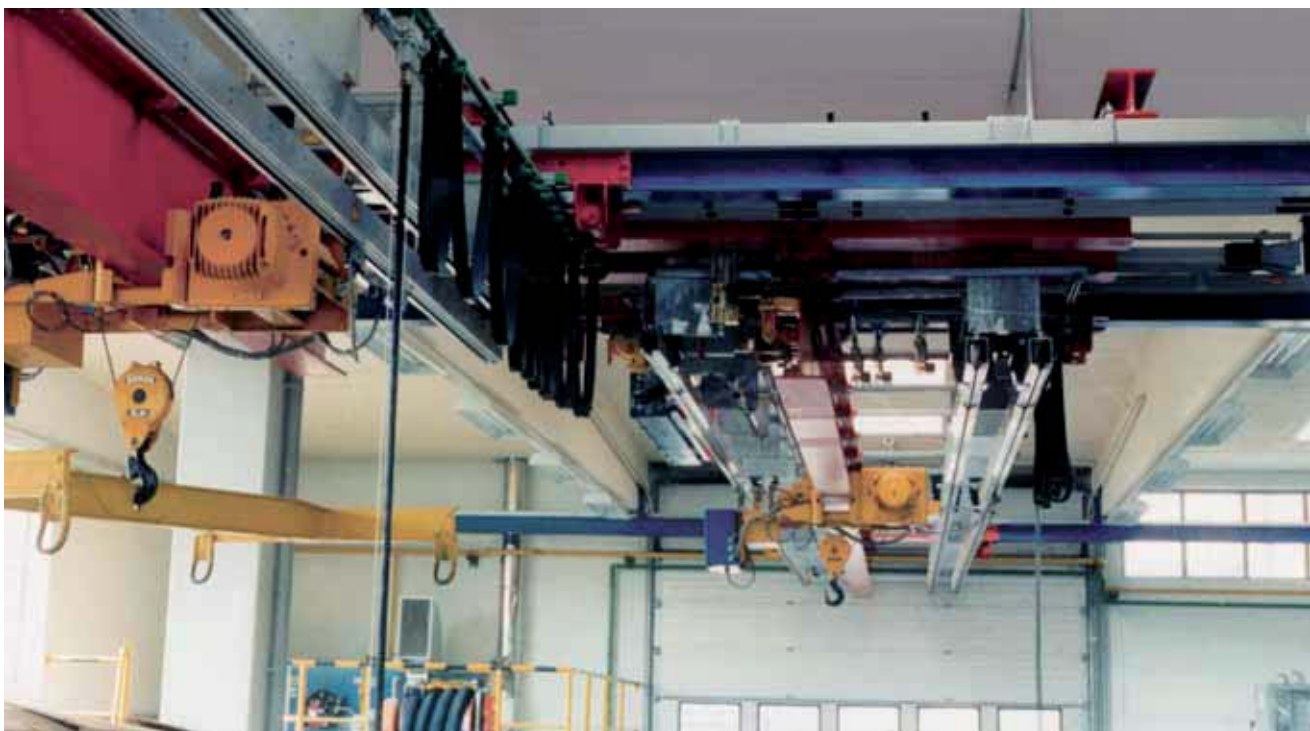
Sicherheits-Schleifleitung an einer Kranbrücke.
