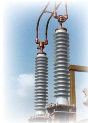
123 kV Kabelendverschlüsse im Jahr 1975 installiert
