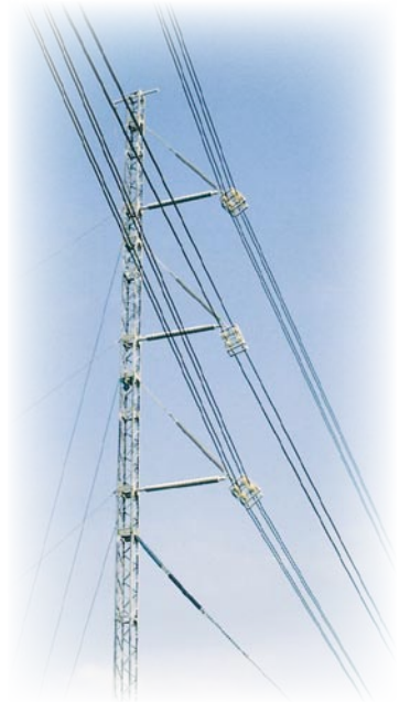
Isoliertraverse für 420 kV Notleitungsast
