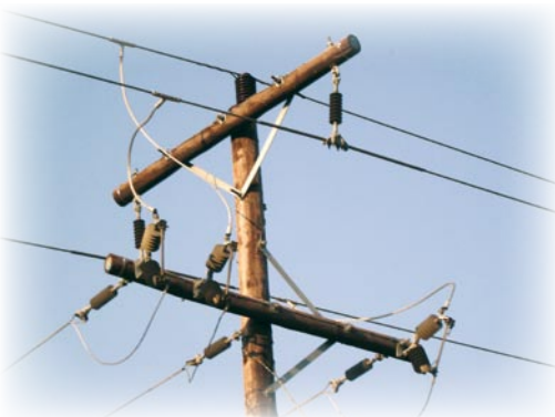
Holzmast mit Trag- und Abspannisolatoren und Cutouts
