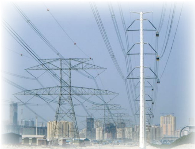
420 kV Kompaktleitung, DEWA
