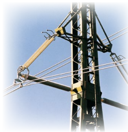
420 kV Isoliertraverse, errichtet im Jahr 1998
