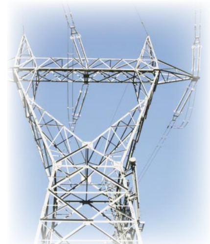
420 kV Leitung mit 500 kN Kraftklasse, ATEL
