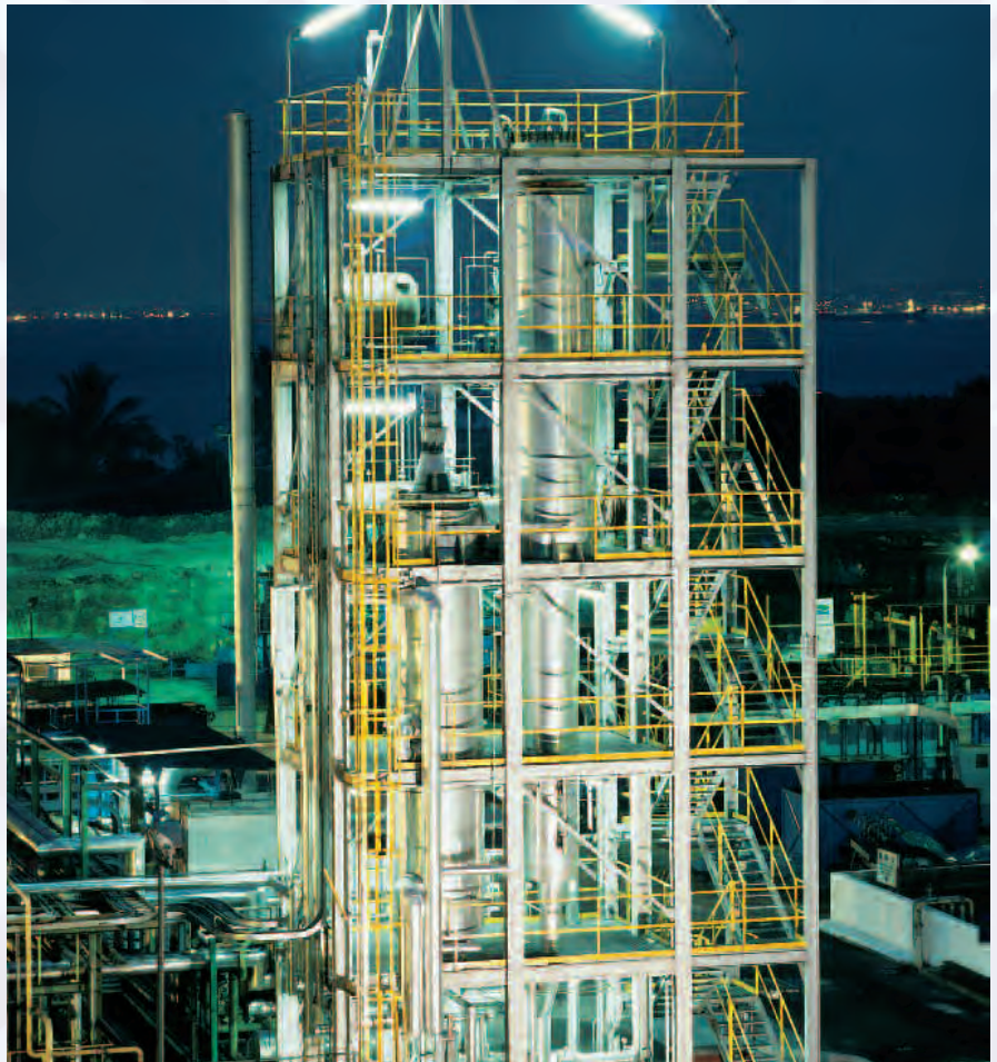
Slop-Oil-Entwässerung und -Destillation (Singapur)
