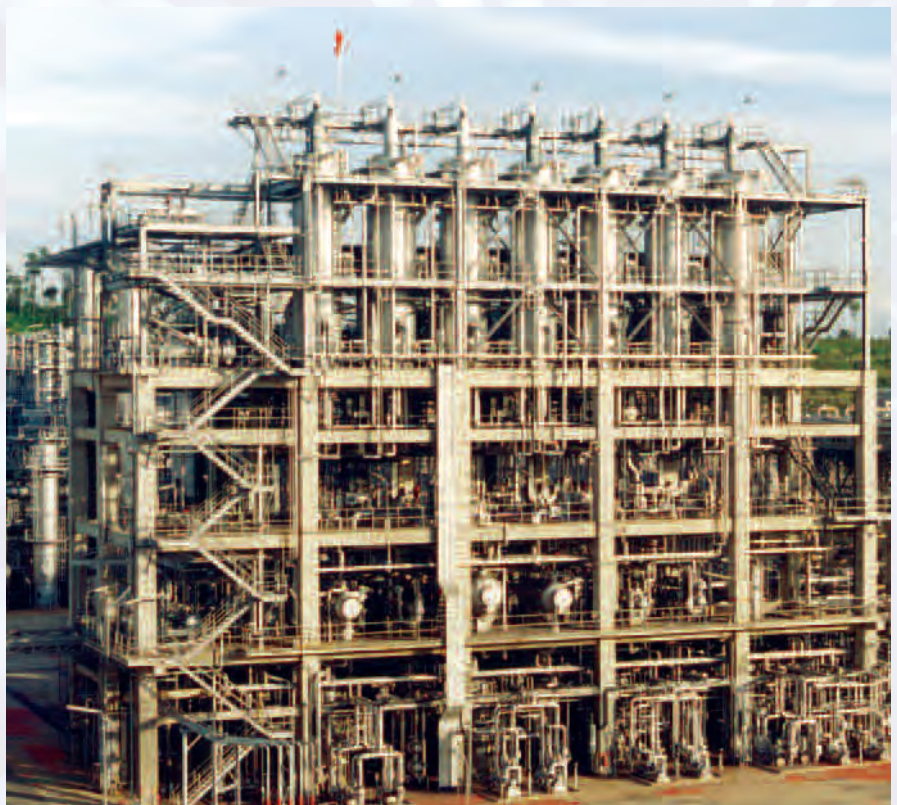
Weltweit größte mehrstufige Kurzwegverdampferanlage zur Produktion von Soft- und Hartwachsen
