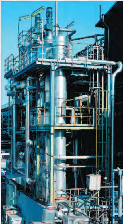
Zweistufige Dünnschichtverdampferanlage zur Harzkonzentrierung
