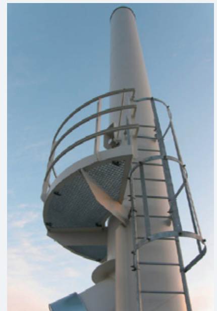
Abgaskamin mit Emissionsmessstelle
