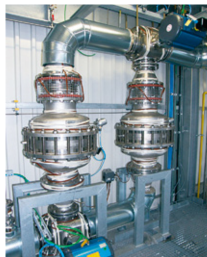
Detonationssicherungen zur Rückbrandsicherung bei Zone 1 Abgasen
