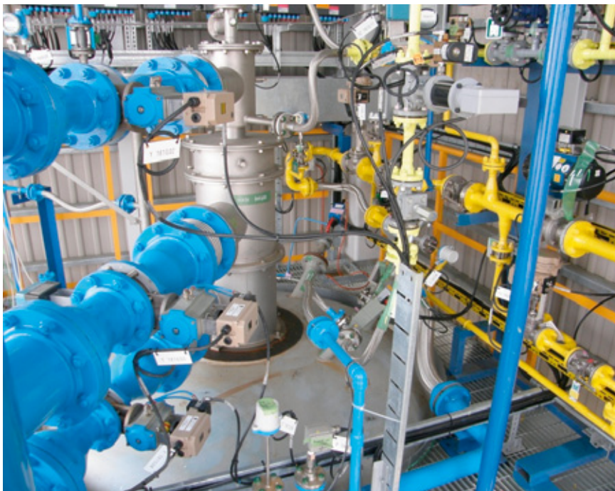
Brennersystem mit Brennstoff- und Abgasstrecke
