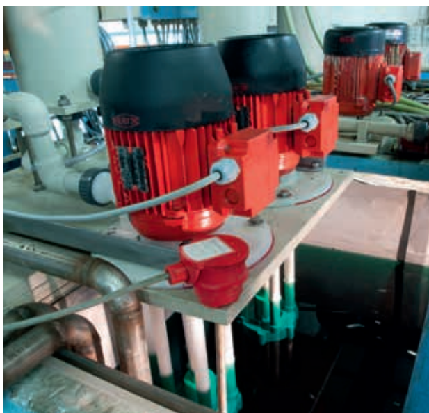
F 716 – Umwälzen von Chemikalien in einem Galvanikbecken.
