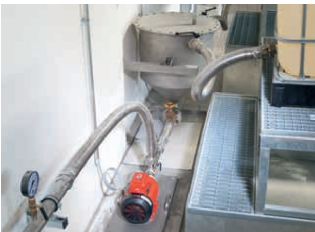
F 550 TR im Industrieinsatz – Fördern von zähflüssigem Weichmacher.
